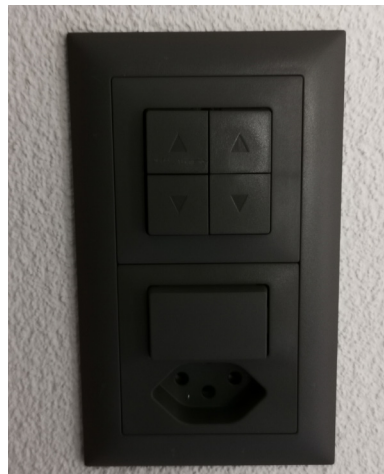
Abbildung 17: Elektrische Installation 1, Archiv Holzbau AG
